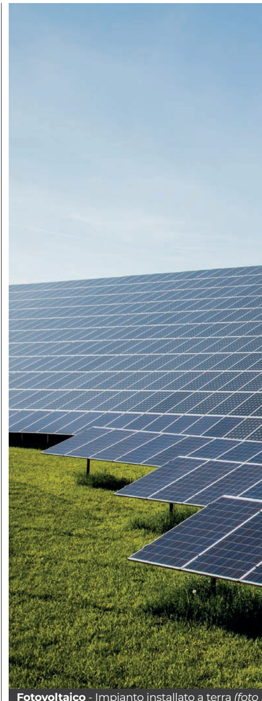
Fotovoltaico - Impianto installato a terra (foto)
